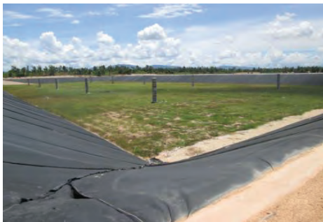
บ่อฝังกลบขยะ (โรงงานลำดับที่ 105)
